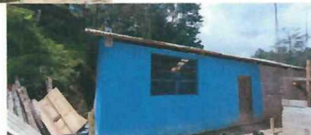
Foto 8: Necesidad de repello y colocacion de ventana
