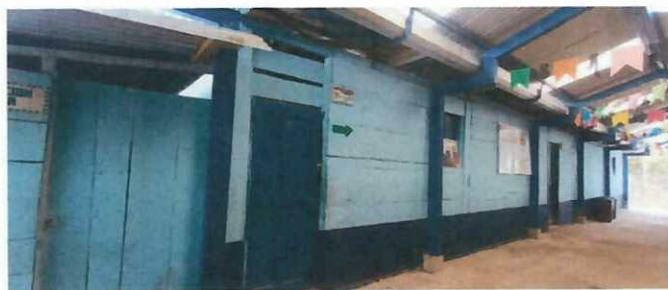
Foto 10: Se necesita colocar ventanas a las aulas cuando se tenga la pared de block .
