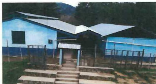
Foto 9: Se Necesita colocar lamina en la pestaña del frente para evitar que el agua se empoce y forme una laguna dentro del corredor
