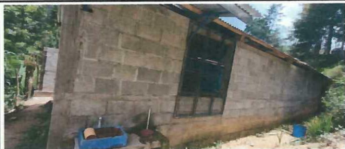
Foto 7: Necesidad de cambio de ventanales, por ventanas de vidrios.
