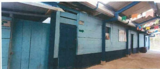
Foto 2: En la parte del frente las aulas de madera con cemento ya iniciado, necesita sustitucion de madera por block
